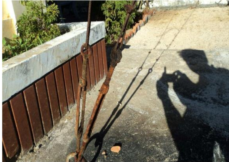
Hình 3. Mố néo của cột gió bị muối mặn ăn mòn
