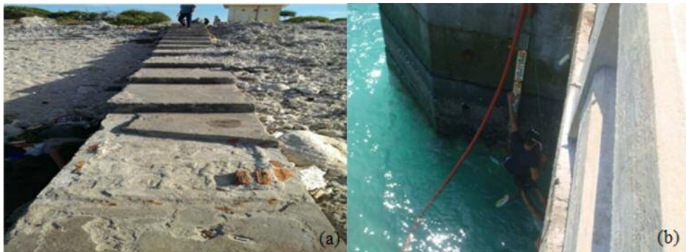
Hình 2. (a) Công trình tuyến đo bị sóng đánh hỏng; (b) Bảo dưỡng cạo hà cọc thủy chí.
