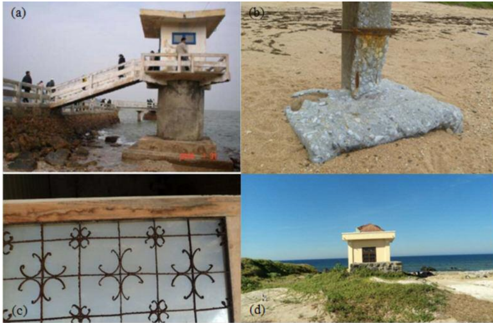
Hình 1. (a) Nhà giếng triều ký xuống cấp; (b) Chân nhà giếng triều ký bị nước biển ăn; (c) Cửa sổ nhà giếng bị muối mặn ăn mòn; (d) Giếng triều ký bị muối mặn làm hỏng mái tôn và bão làm lật mái.
