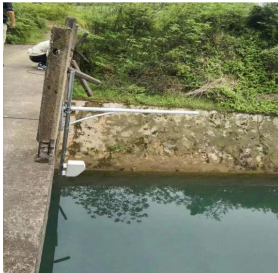
Hình 15. Trạm đo lưu lượng trên sông được lắp trên cầu
