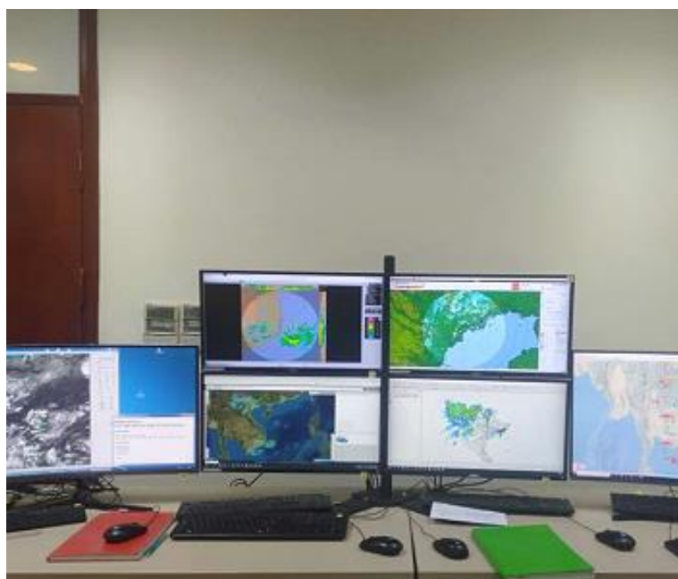
Hình 4. Hệ thống quản lý mạng lưới trạm radar và trạm phát hiện giông sét tại Đài khí tượng Cao không
