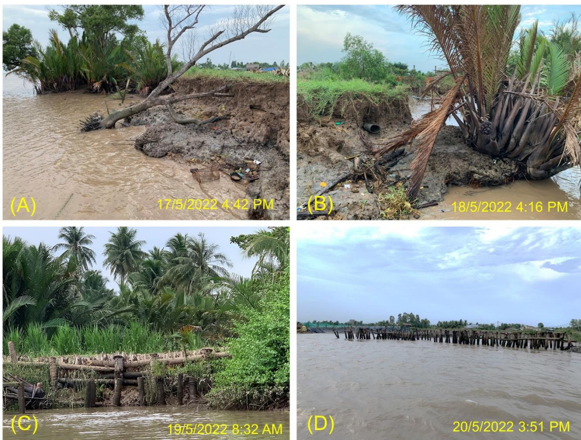
Hình 10. Sạt lở bờ sông Hàm Luông uy hiếp vườn cây ăn trái và ao nuôi thủy sản (A, B); và một số giải pháp khắc phục tạm thời của người dân địa phương (C, D). Vị trí hình ảnh được chụp trong chuyến khảo sát thực địa, tương ứng với các vùng A, B, C và D trong Hình 9e.
